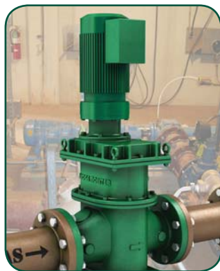
Sludge Monster se nalazi na liniji za mulj
